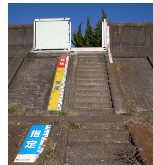
既設階段は基本的に管理用の階段であり、一般利用者が安全に昇降できない
