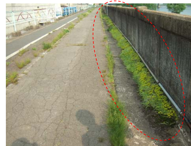
コケ類の繁茂状況
