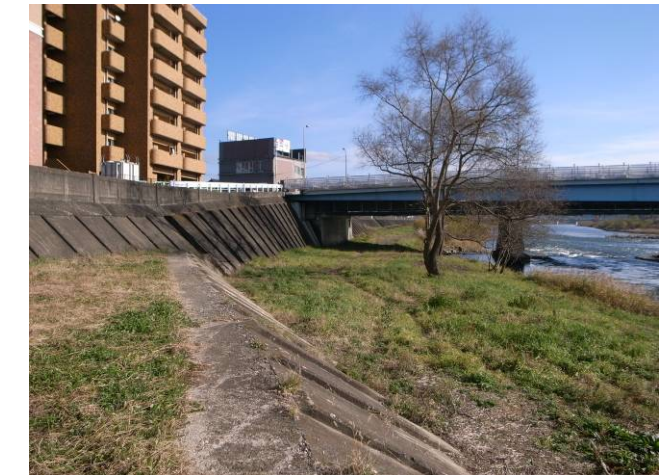
既設護岸により、安全に通行ができない(明治橋(下流方向)を望む)
